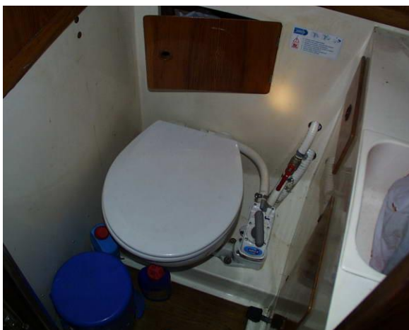
Фото 9. Виден дополнительный отсечной вентиль залива; вентиль фановой магистрали находится под ручкой.
